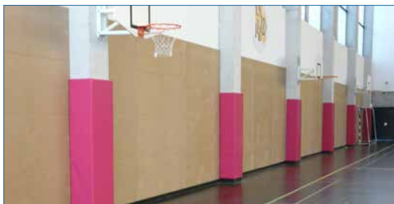
Réf. 60 020 Sur poteau béton.
